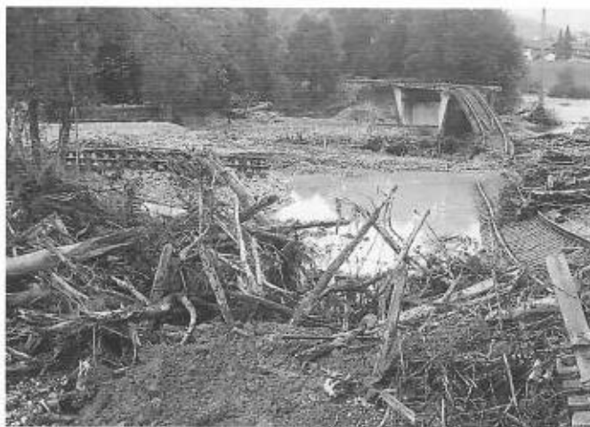
Zwischen Altstädten und Fischen an der Strecke Immenstadt - Oberstdorf ist der Bahndamm zwischen den zwei Illerbrücken vollständig zerstört. (Foto: H. Bischoff, 23.8.05)
